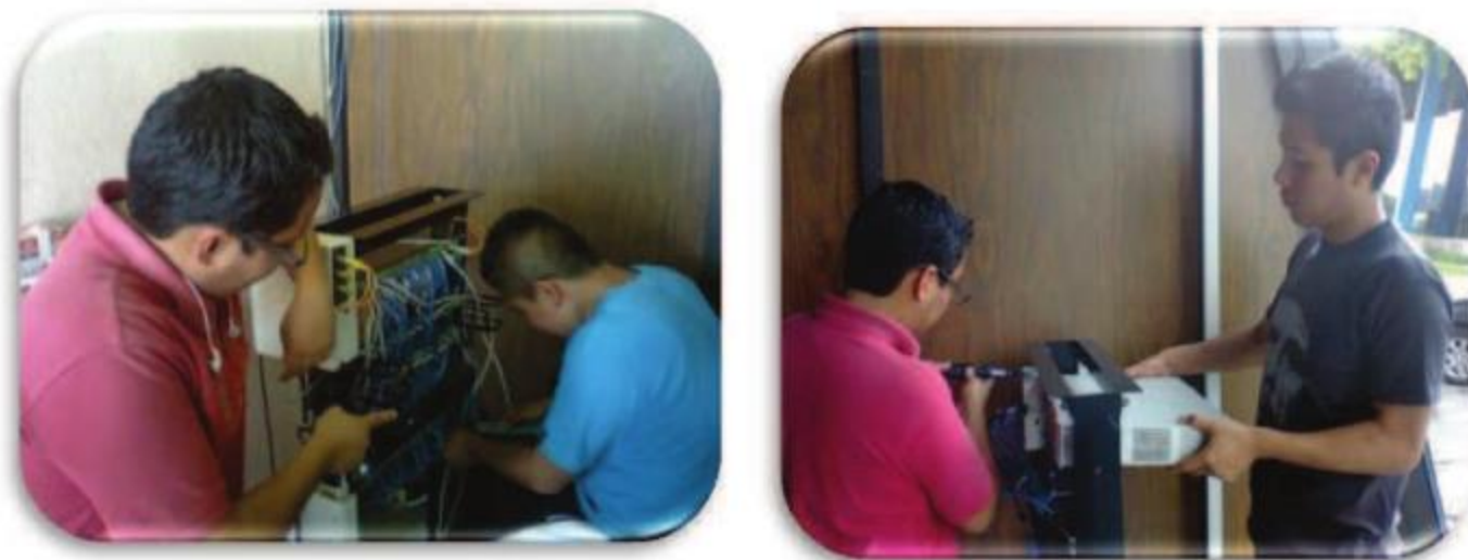
Mantenimiento a switch de comunicaciones de la Red de cómputo de la UTN.
